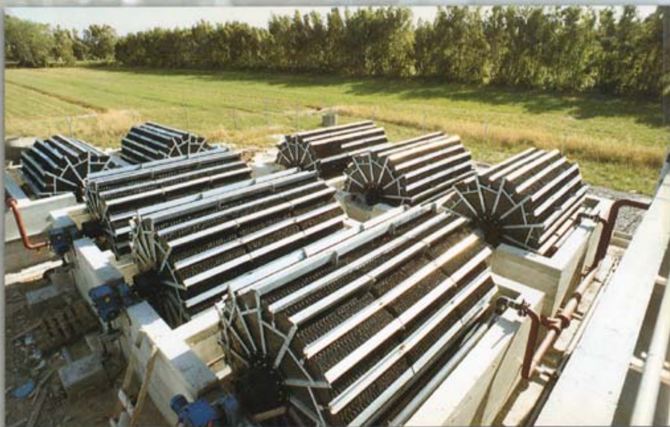
IMPIANTO BIOLOGICO A BASSO CONSUMO ENERGETICO PLANTA BIOLÓGICA DE BAJO CONSUMO ENERGÉTICO
