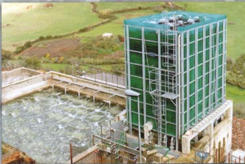
IMPIANTO BIOLOGICO PER ACQUE AD ALTO CARICO ORGANICO PLANTA BIOLÓGICA PARA AGUAS DE ALTA CARGA ORGÁNICA
