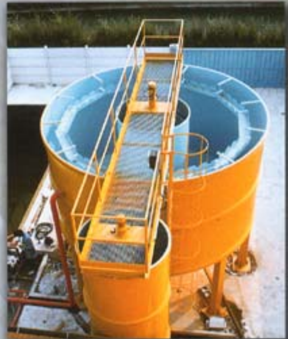
IMPIANTO CHIMICO FISICO PER INDUSTRIA GALVANICA PLANTA QUÍMICO FISICO PARA INDUSTRIA GALVANICA
