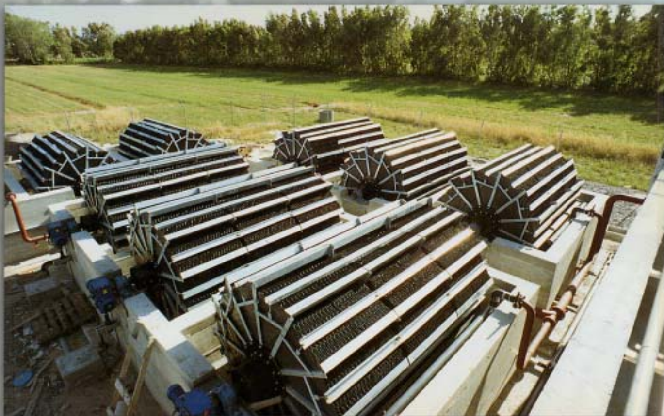
IMPIANTO BIOLOGICO A BASSO CONSUMO ENERGETICO BIOLOGICAL PLANT WITH LOW ENERGETIC IMPACT
