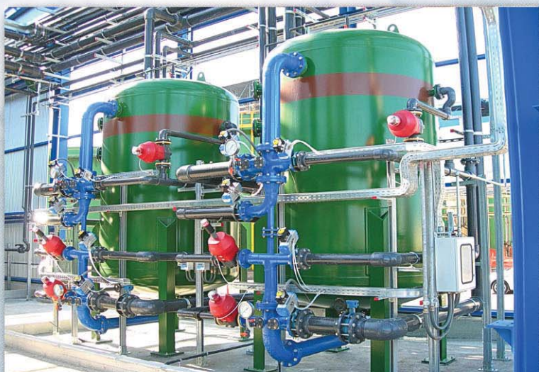
IMPIANTO DI DEMINERALIZZAZIONE PLANTA DE DESMINERALIZACIÓN
